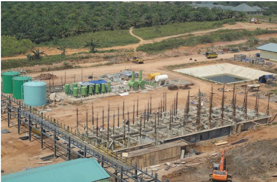
Gambaran Area pabrik demineralisasi pengolahan air dan cooling tower
